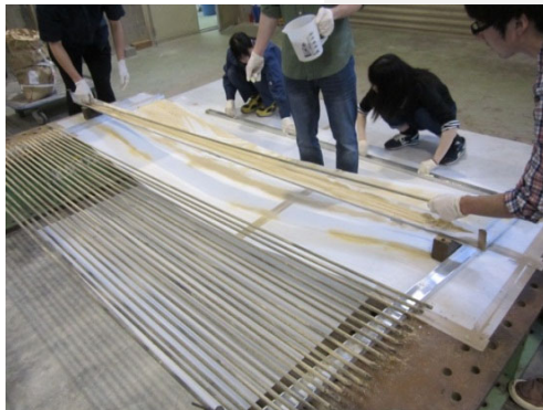
CFRPロッド主筋
