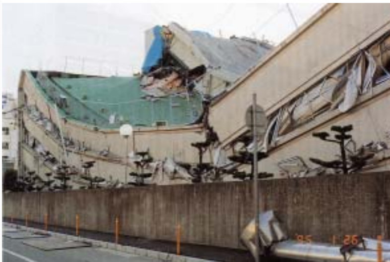
全層が崩壊した4階建て事務所ビル
