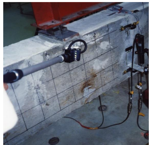
剥離診断機による打込み型枠の剥離状況調査
